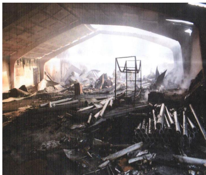
Рисунок 2 – Складское здание с железобетонным и металлическим каркасом после пожара
