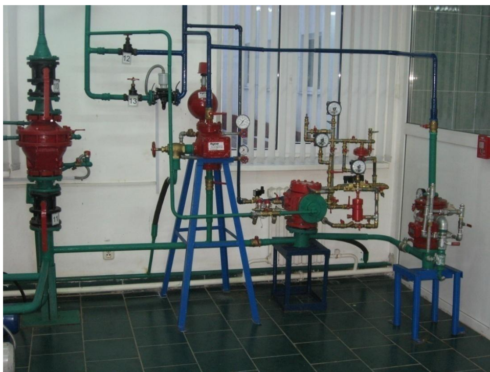
Рисунок 1 - Внешний вид лабораторной установки автоматического водяного пожаротушения
