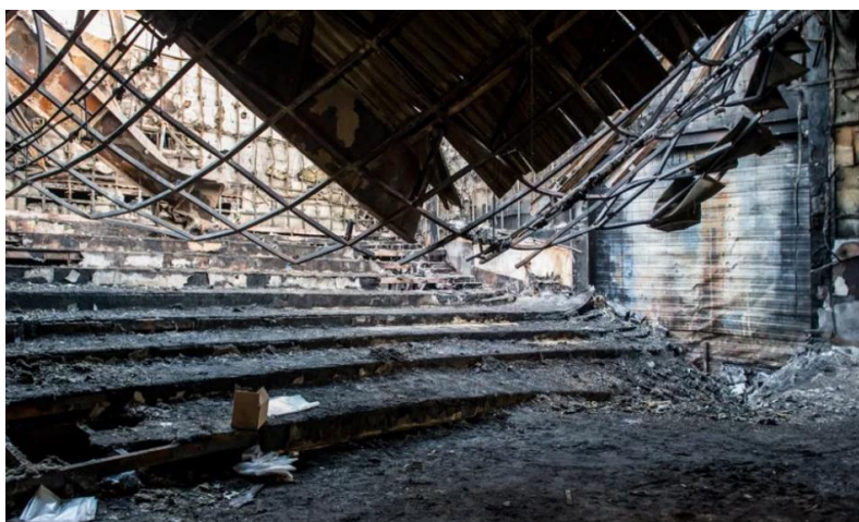
Рисунок 4.5. Деформация металлических конструкций на пожаре
