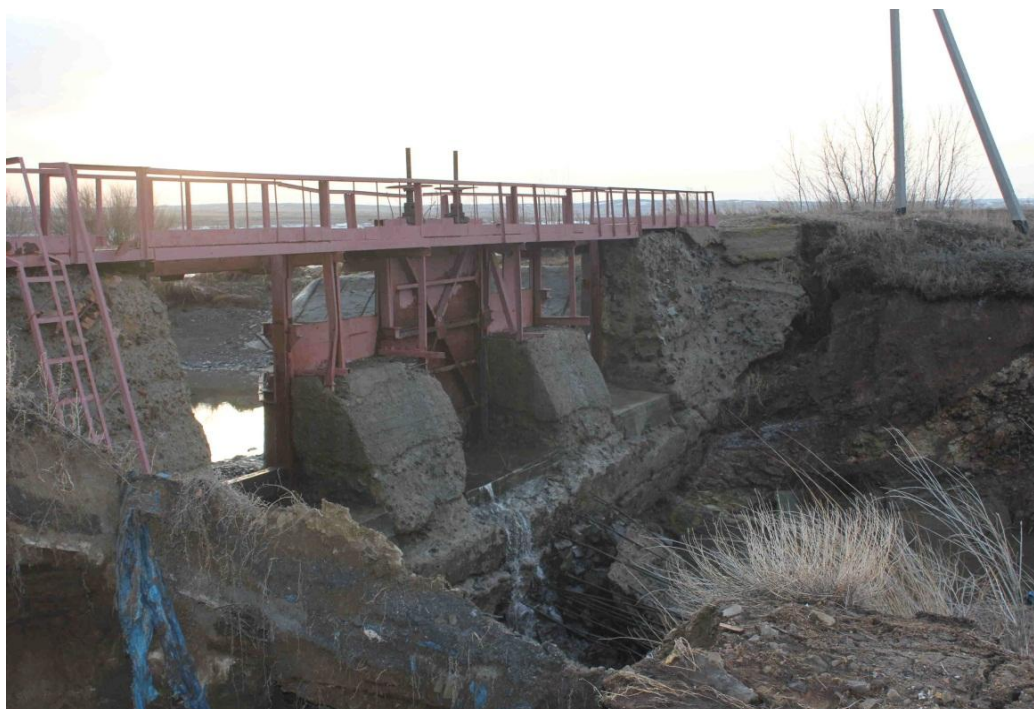
Рисунок 39 -Авария на плотине Кокпекты
