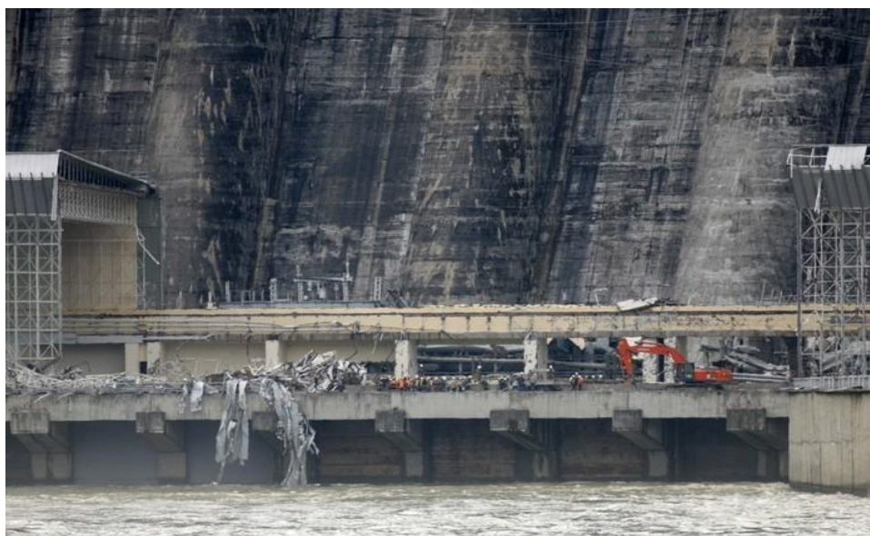
Рисунок 4 - Последствия аварии на Саяно-Шушенской ГЭС
